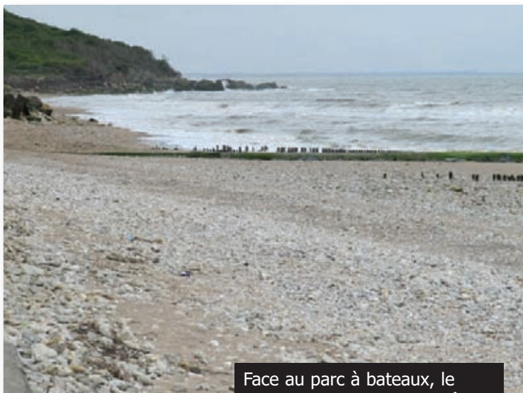
L'épis, situé face au casino, se dégrade.
